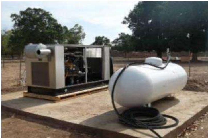
Production d'électricité par Hydrogène Naturel au Mali sur le site pilote de Bourakébougou (1 ère mondiale), source Hydroma inc
