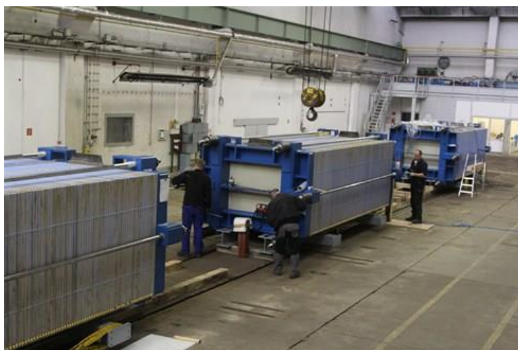
Figure 3 – Trois unités d'électrolyseur alcalin Enertrag de 2 MW unitaire – 1000 m 3 /h
