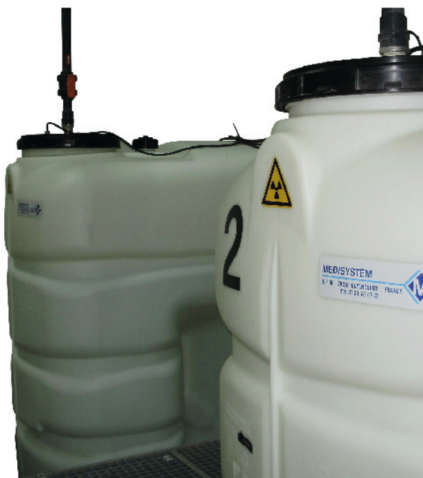
Cuves de décroissance
