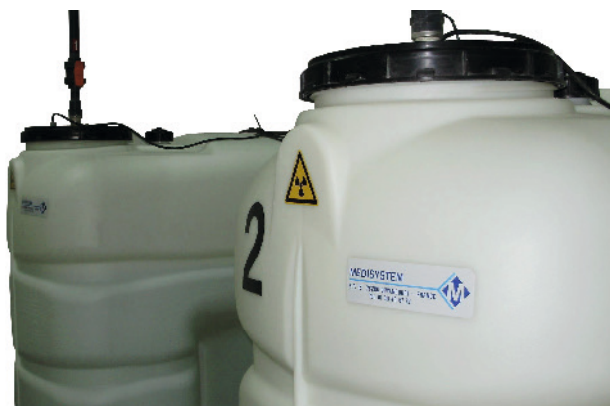
Cuves de décroissance
