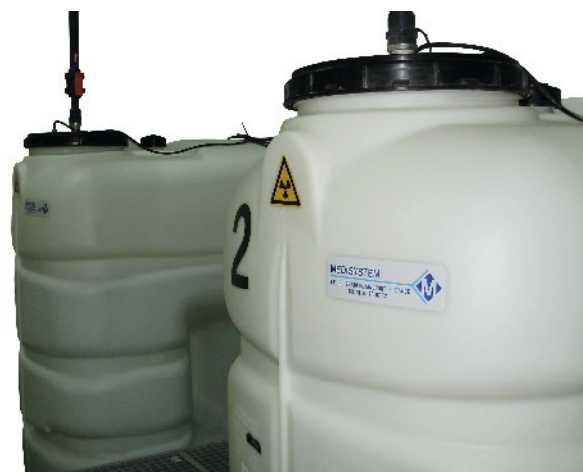
Cuves de décroissance
